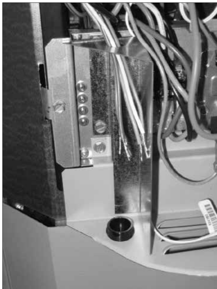
Figure 6. Compartiment basse tension pour câblage de commande
